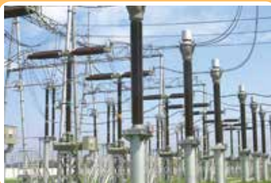
پست تقویت ولتاژ جریان برق
