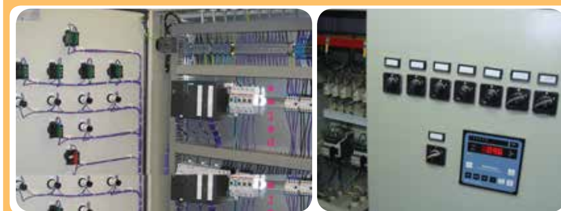
تابلوهای برق صنعتی موجود در کارگاه‌ها
